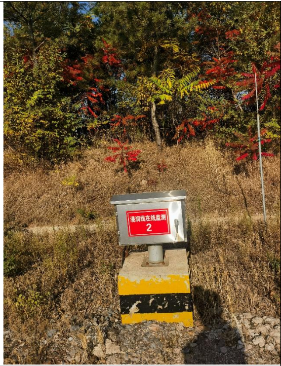
浸润线在线监测装置
